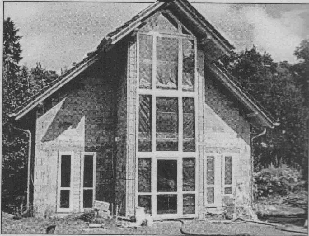
Dieses Haus besteht vom Keller bis zum Dach aus natürlichem, hochwertigem Edel-Bimsstein.
